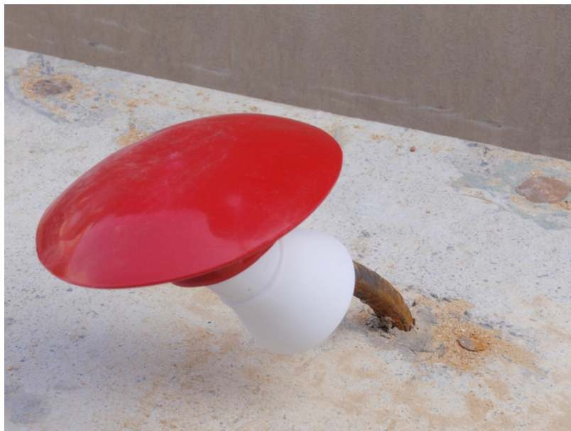
Fotografía 7: Disposición de la protección tras el primer impacto. No se produce perforación de la barra en la protección.
